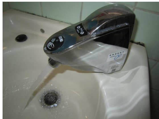
自動水栓機 5台
